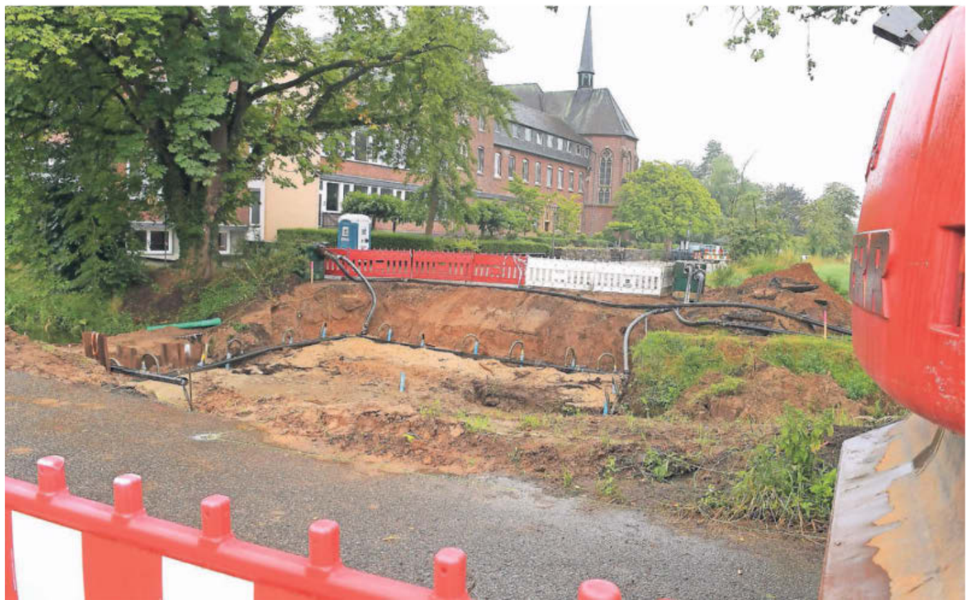
Die Brücke über die Schleck an der Abtei Mariendonk in Mülhausen ist weg.
